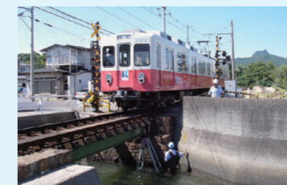
写真1：高松琴平電鉄の橋梁で実施しているポリマーセメントモルタルの海岸線露露試験の様子
